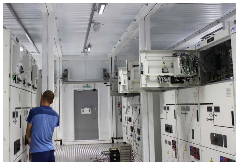
Наладка ячеек ЗАПАД в БМЗРУ
